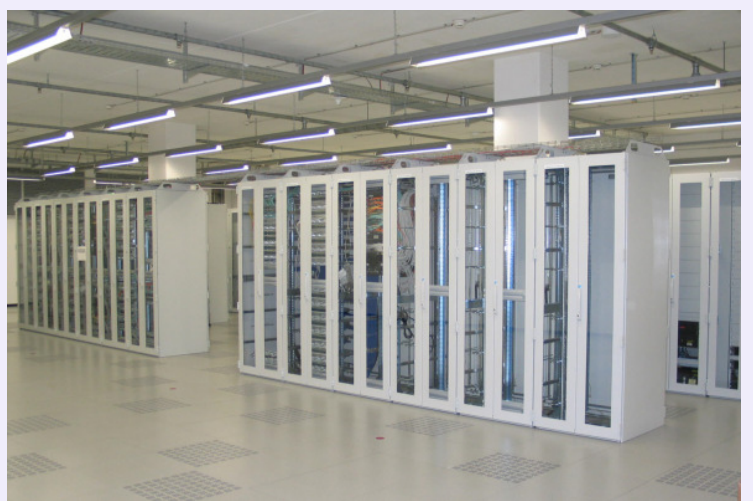
Insgesamt installierte die HUK Coburg 75 neue, geschlossene IT-Racks von Rittal im neuen Rechenzentrum Input Output (RIO)
