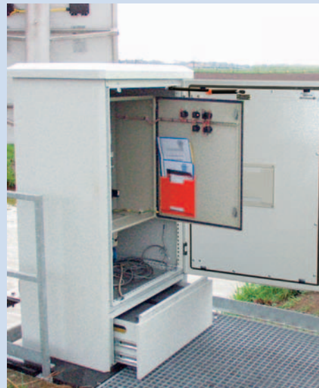
Pegelmessung eines Kanals und Ablaufsteuerung einer Schleuse Schutz durch das robuste CS Modulgehäuse.
