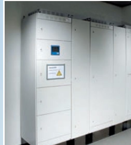
Die Ri4Power Niederspannungs-Unterverteilung gewährleistet ein Höchstmaß an Sicherheit.
