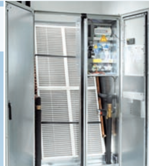
Die neuen Rittal Doppelbodenfluter dienen der Grundlastkühlung des Rechenraums.
