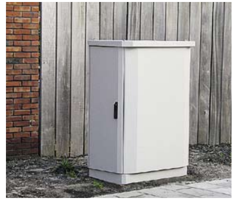
FTTC – Gehäuse mit verdeckter Klimatisierung ohne sichtbare Lüftungsschlitze.
